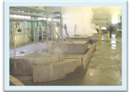
③抽出機 (液料 : 60m 3 × 6基)
